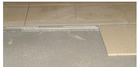
Sicherheit beim Verlegen von Fliesen auf veröltem Untergrund
